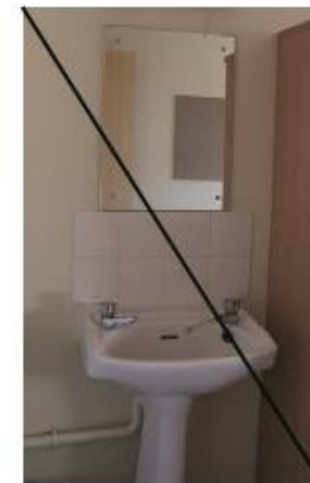
Плохо Раковина с пьедесталом. Фартук из плитки
